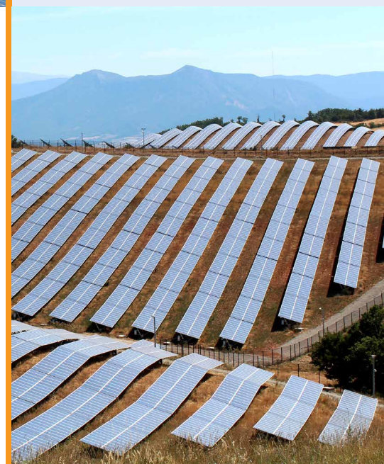
« Les Mées » - Centrale au sol d'une puissance installée de 10,1 MWc de modules Yingli Solar.
